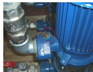
Rys. 8: Montaż przetwornika do otworu odpowietrzającego na dostawie pompa
