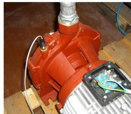
Rys. 5: przykład otworu zalewowego pompy z zamontowanym przetwornikiem
