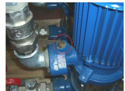
Rys. 7: Montaż przetwornika do otworu odpowietrzającego na dostawie pompa
