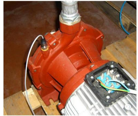
Rys. 4: przykład otworu zalewowego pompy dostawa z zamontowanym przetwornikiem
