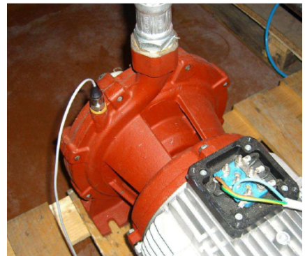
Rys.2 : Przykład otworu zalewającego pompy wraz z zamontowanym przetwornikiem
